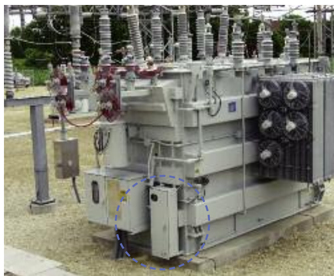
Los medidores de la presión de suministro y del tanque del Sistema de Gas Inerte N2 se pueden ver fácilmente desde la mirilla en la puerta.
