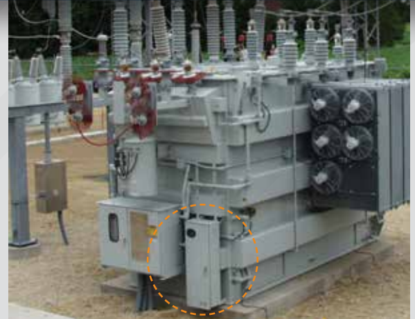
Los medidores de la presión de suministro y del tanque del Sistema de Gas Inerte N2 se pueden ver fácilmente desde la mirilla en la puerta.
