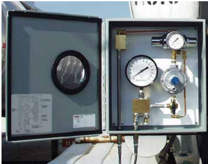
Los indicadores de presión del suministro y tanque en el Mini Sistema de gas inerte se pueden ver fácilmente desde la mirilla en la puerta del gabinete.
